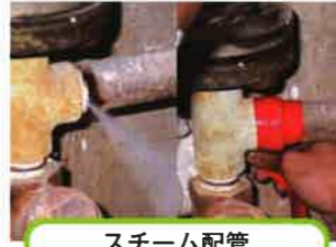
スチーム配管
